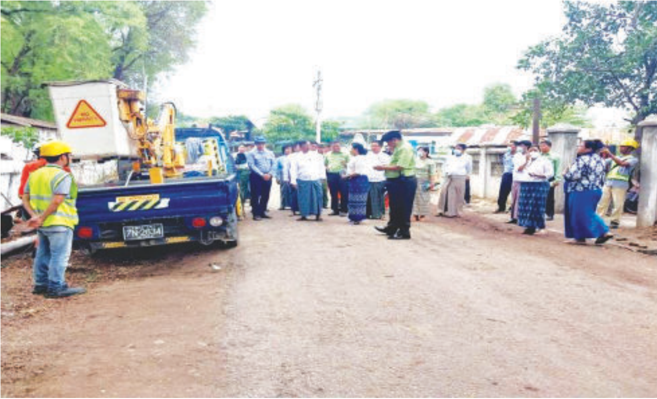
နေပြည်တော်ကောင်စီဥက္ကဋ္ဌနှင့် အဖွဲ့ဝင်များ 200 KVA Transformer နှင့် မီးကြိုးမီးတိုင်များ ပျက်စီးနေမှုများအား ယာဉ်ယန္တရားများဖြင့် ဖယ်ရှားရှင်းလင်းနေမှုအား ကြည့်ရှုစစ်ဆေးစဉ်။
